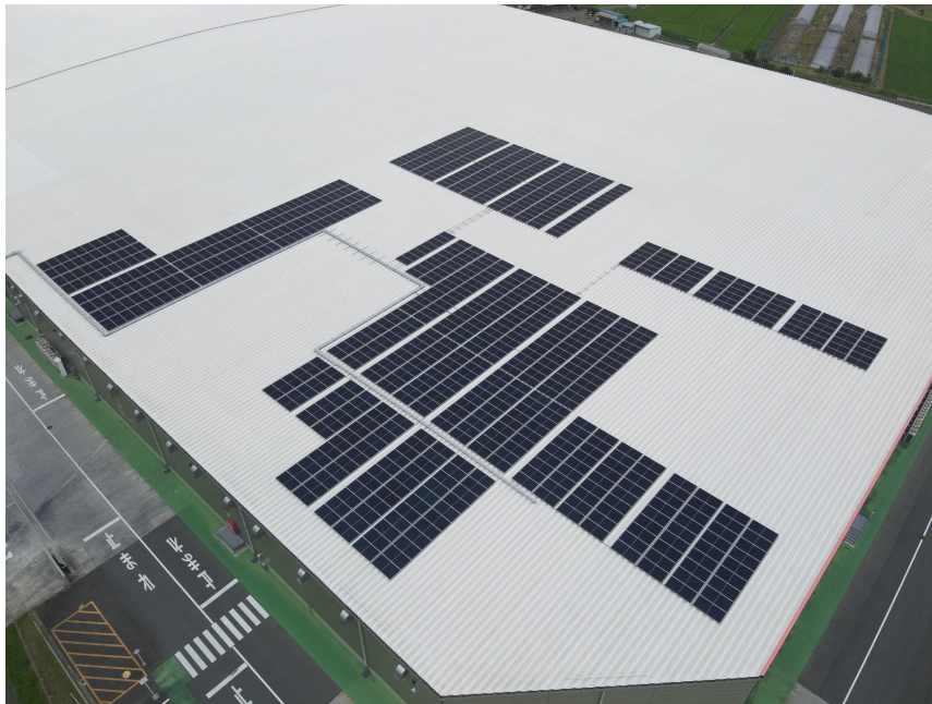
（茨城中央サテライトセンターの屋根上に設置した太陽光発電パネル）
